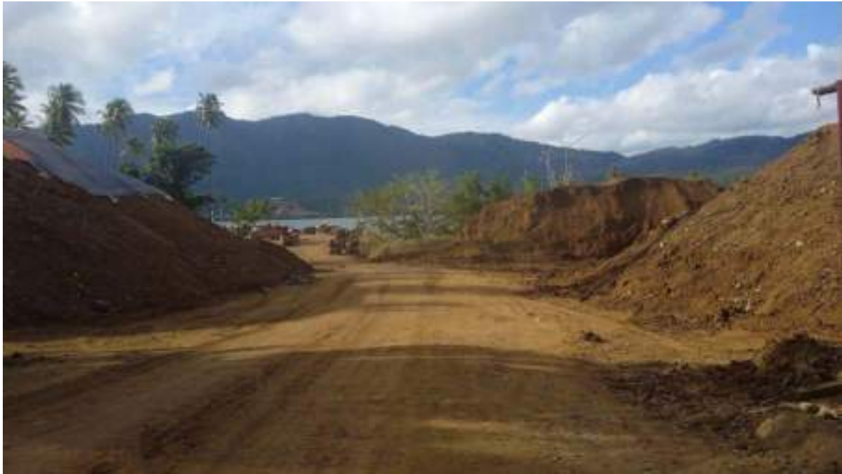
Proses pembangun pelabuhan bongkar muat hasil pertambangan nikel di Desa Siuna (foto dokumen mediabanggai.com).
