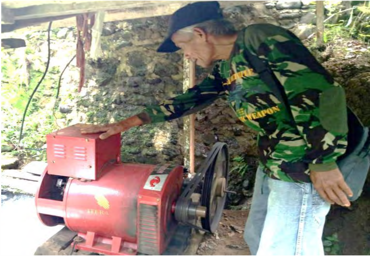
Suratman mengecek kondisi generator turbin PLTMH di desa setempat. Lampost.co/Setiaji Bintang Pamungkas
